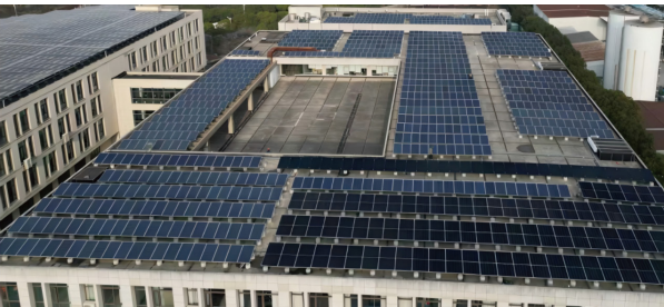
光伏发电设备
