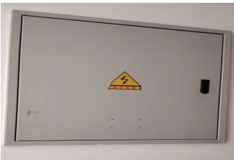
2025.3.5厨房配电箱危险标识张贴错误
